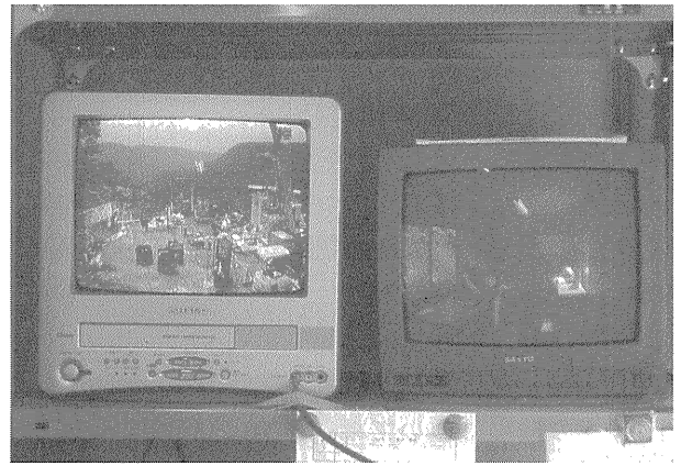
写真—9 現場事務所遠隔監視機器
