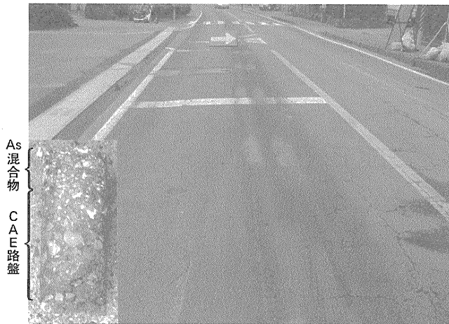
写真一 供用性能の低下した道路
