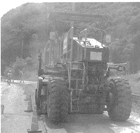
写真—5 破碎状況
