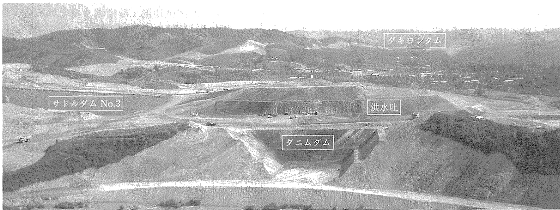
写真—1 ダニムダム・洪水吐掘削とサドルダム No.3 盛立て状況
