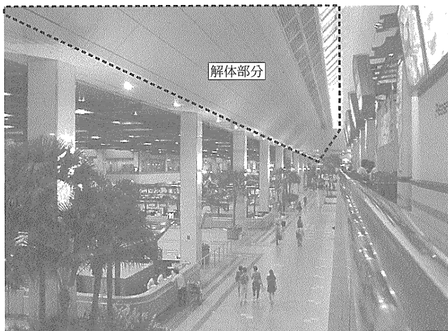
写真-4 出発階スカイライト部分 (改修前)
