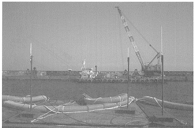
写真—4 無線 LAN アンテナ群
