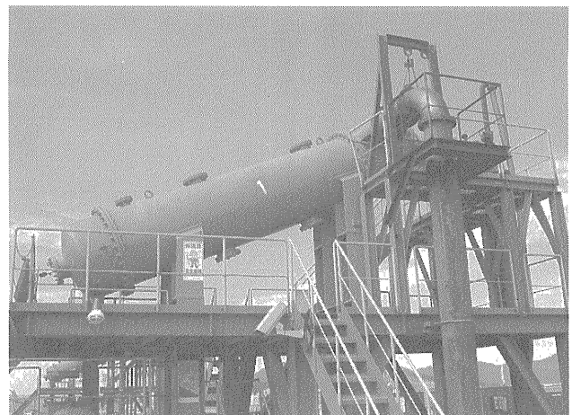
写真-14 ソイルセパレータ
