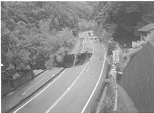
① 崩落状況 全面通行止め
