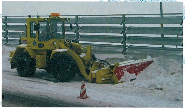
⇩防雪柵柵下除雪状況
