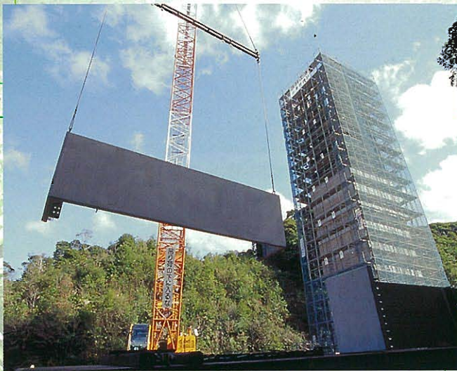
⇨ 3Hパネルの設置状況: 工場製作した3Hパネルをクレーンにより所定の位置まで吊上げ、設置します。
