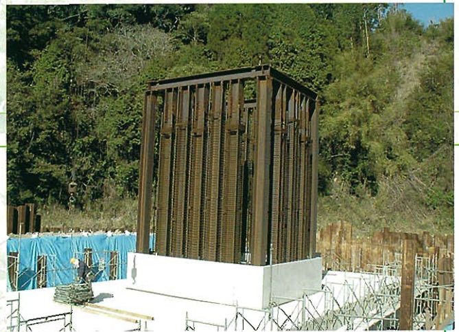
⇨ スパイラルカラム第1ロット: 第1ロットのスパイラルカラムの建込み精度は、その後の施工精度に大きく影響するため、各スパイラルカラムの頭部を連結し、フーチングコンクリートを打設します。
