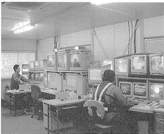
写真-3 バッチプラントオペレーションルーム
