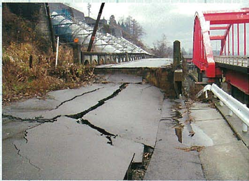
写真-12 / 山辺橋の被災状況 (右が新橋)
