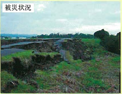
被災状況 ↑写真-1 / 三俣町の堤防被害
