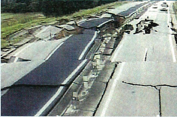
写真-10 / 被災直後の状況 (写真提供: 日本道路公団)
