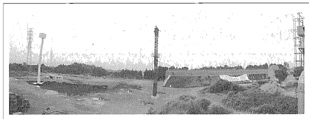
写真-2 試験設備全景
