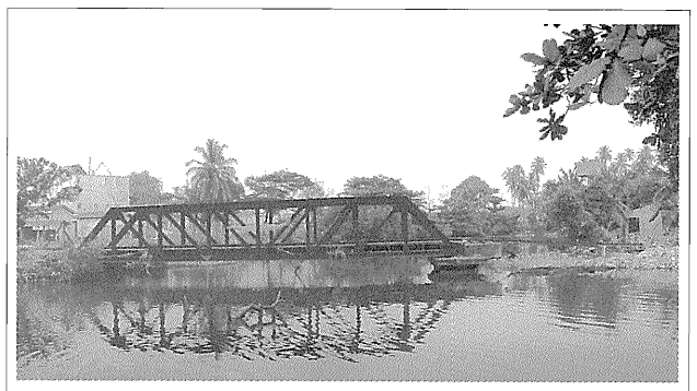
写真五 洗掘された橋台
