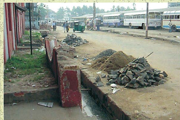
⇩G-6 崩壊した塀(ゴール)
