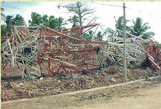
↑G-12 崩壊した無線鉄塔(ハンバントータ)
