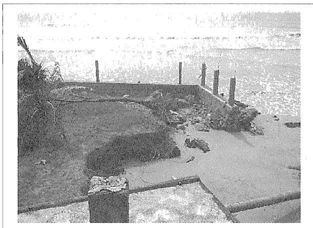
写真—10 Paiyagala における海岸侵食
