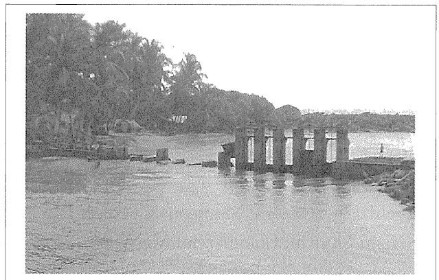
写真-7 被災したゲート
