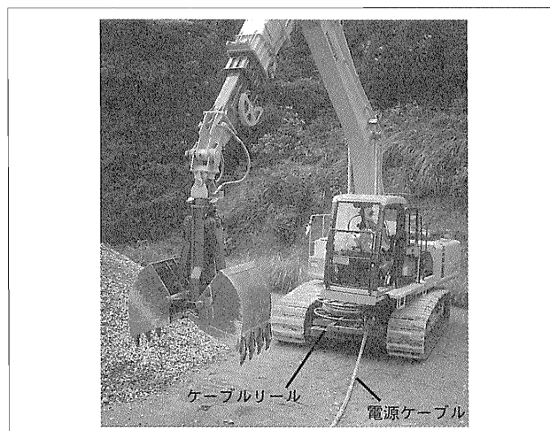
写真一 電動クラムの外観
