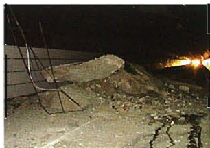
被災状況(H16.10.24)
