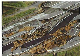
被災状況(H16.10.24)
