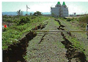
被災状況(H16.10.24)
