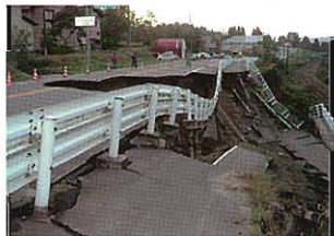
被災状況(H16.10.24)
