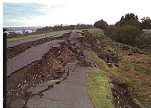
被災状況(H16.10.24)
