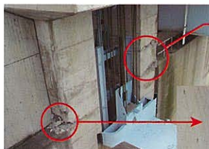
被災状況(H16.10.24)
