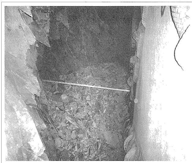
写真-3 先掘れ状況 (下半部)
