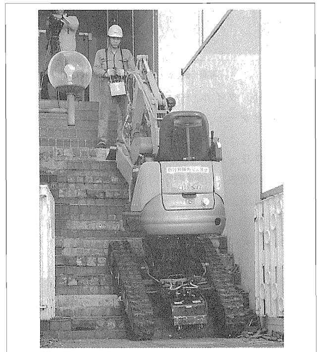
写真-2 階段の昇降。オペレータは遠隔操作で運転を行う
