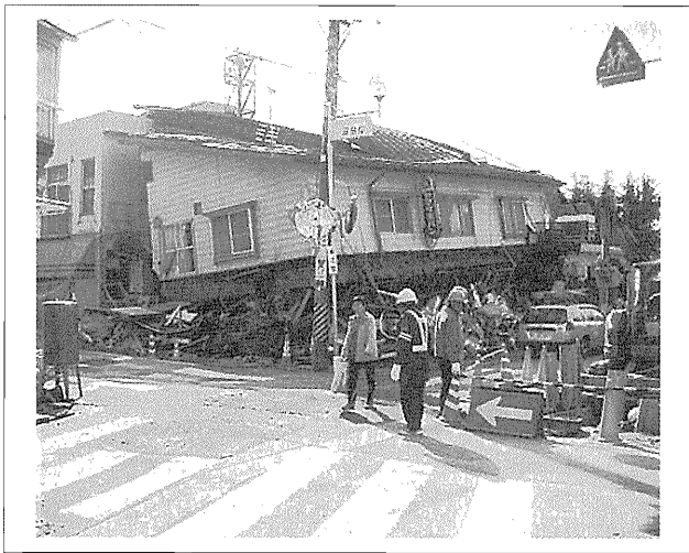
写真—4 建物の被災（川口町）
