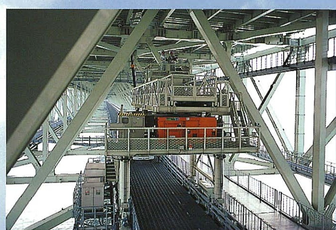
⇩明石海峡大橋:橋梁点検補修作業車(桁内面作業車)による点検
