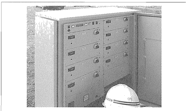
写真—7 直流電源装置
