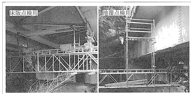
写真—6 点検用簡易足場
