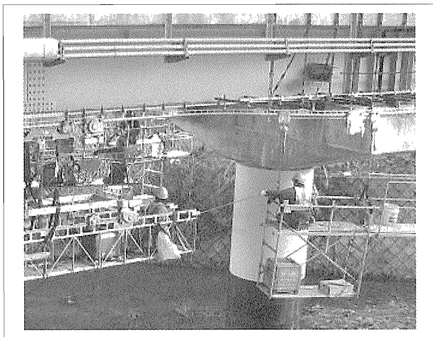
写真—11 作業床のスルー状況
