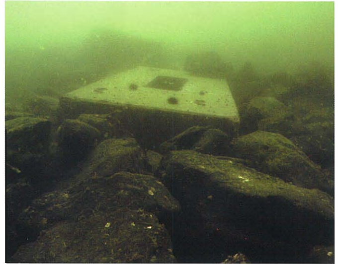
⇨被災した根固めブロック
