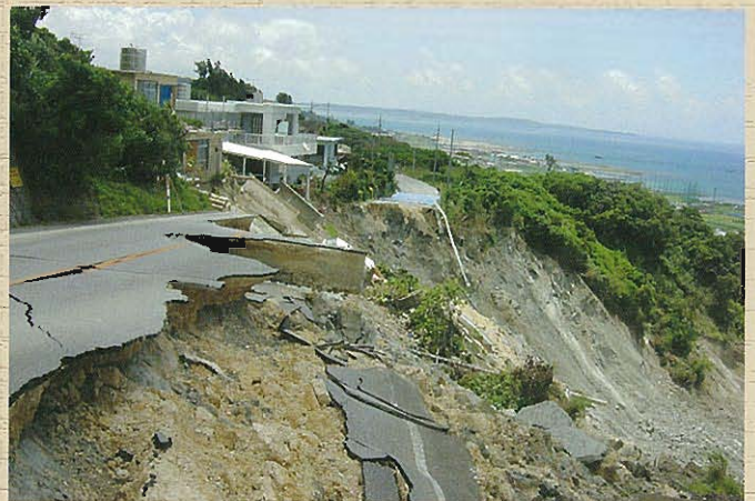
↑現地被災状況
