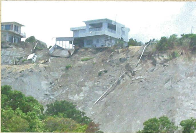
↑現地被災状況
