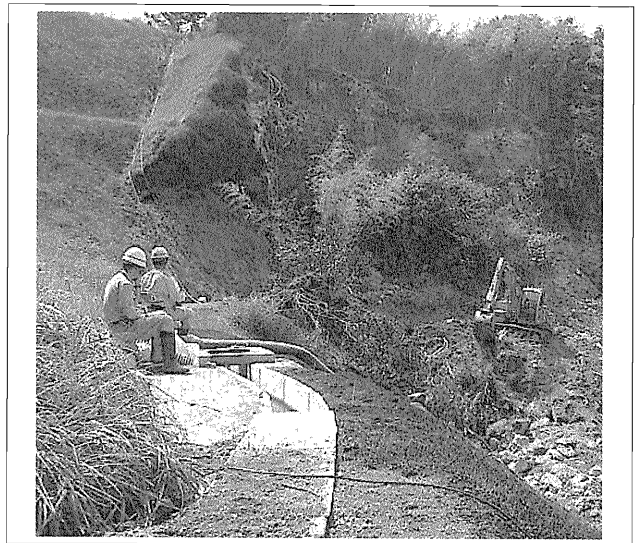
写真-5 稼働状況
