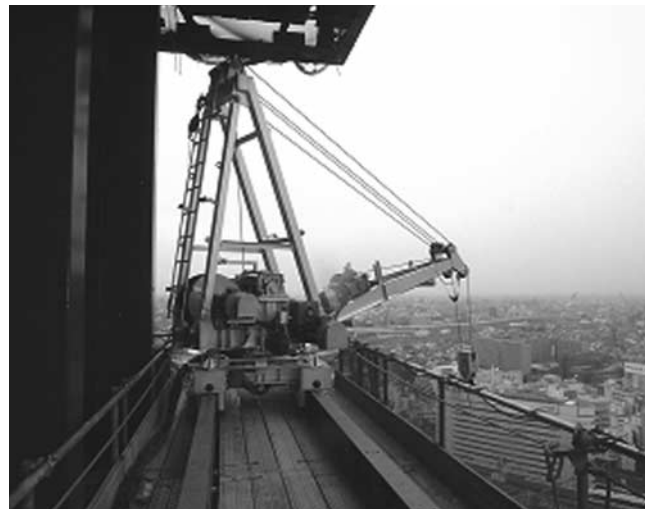
写真-7 シャトルクレーン
