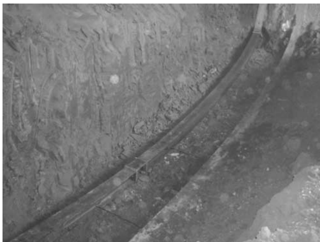
写真一六 インバートストラット
