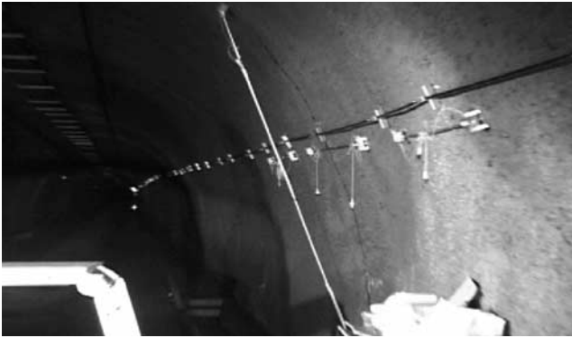
写真一 距離方向センサの設置状況
