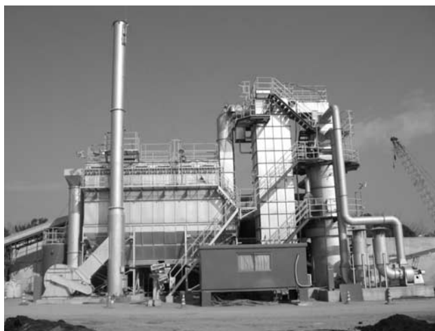
写真—2 加熱乾燥プラント
