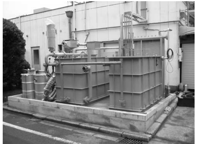
写真—5 揚水曝気装置の設置例
