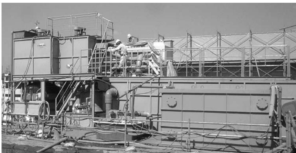
写真一 3 除外設備
