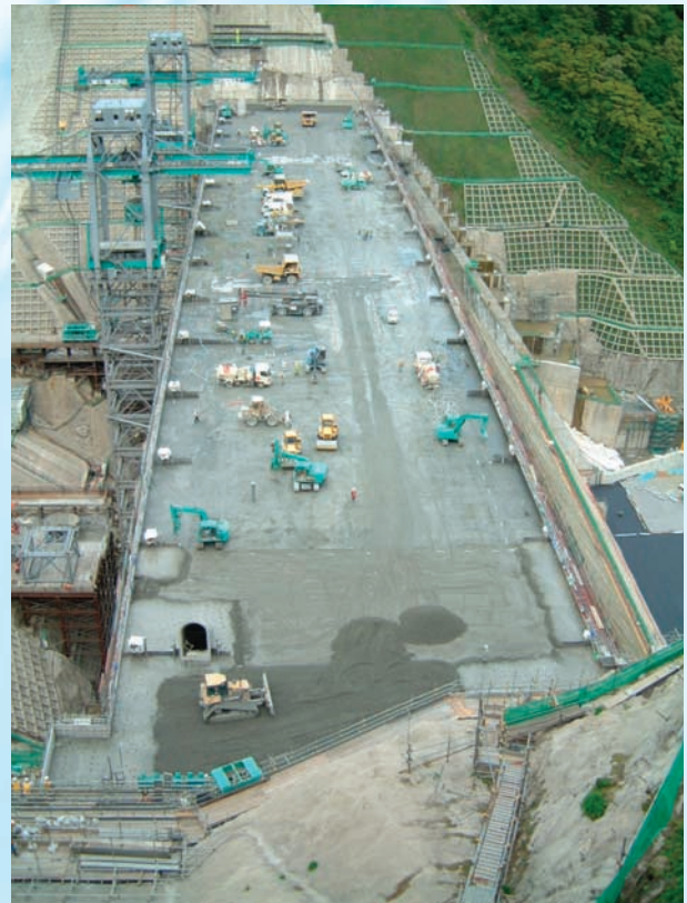
⇩ 全面連続打設のRCD工法施工状況(全平面を分割なし, 打込厚 0.4 m)
