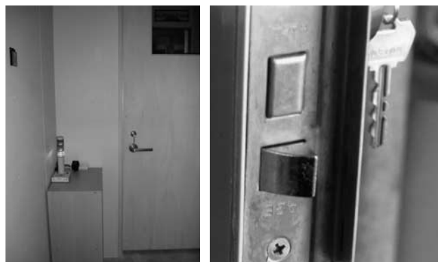
写真一 2 入場扉と電気錠
