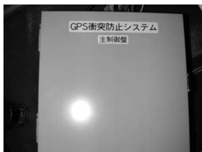
システム制御 BOX
