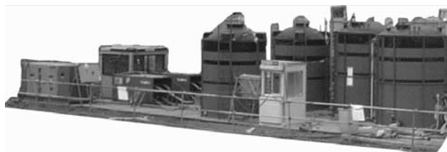
写真—8 薬液プラント
