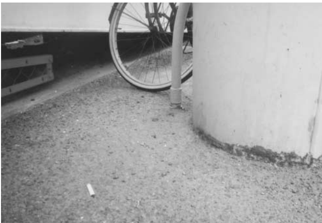
写真一2 塗装替後、更なる根腐れが進行中の橋脚
