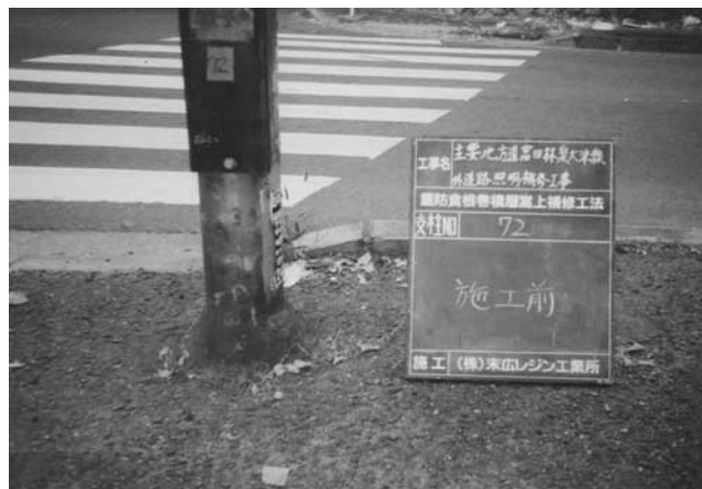
写真—1 根腐れ現状
