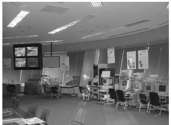
写真二 土石流発生集中監視室
