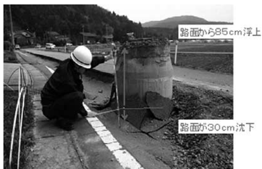
写真—5 下水道マンホール隆起
