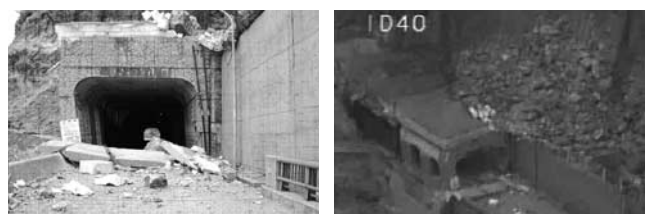
写真二 国道 249 号八世乃洞門の被害状況
