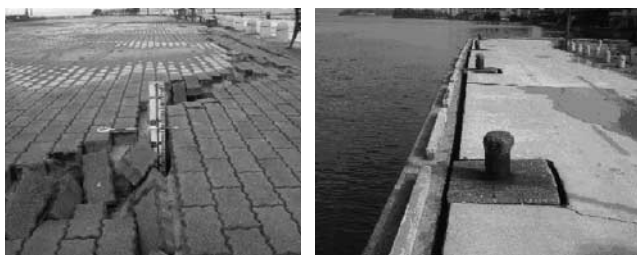
写真—4 和倉港の被災状況（野積場沈下ほか）
