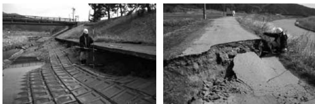
写真—3 ハヶ川の被害状況（護岸欠損、天端陥没）
