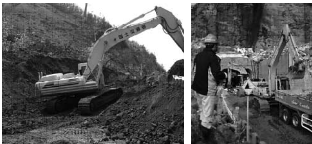
写真—11 遠隔操縦式バックホウによる崩落土砂の撤去作業 (左：門前町深見地内 右：町野町曾々木地内)
