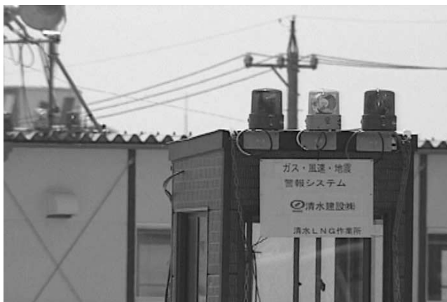
写真—2 屋外に設置されたガス・風・地震の警報器
