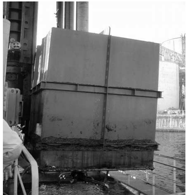
写真-2 鋼製攪拌翼カバー
