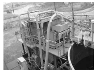
写真-6 サイクロン設備
