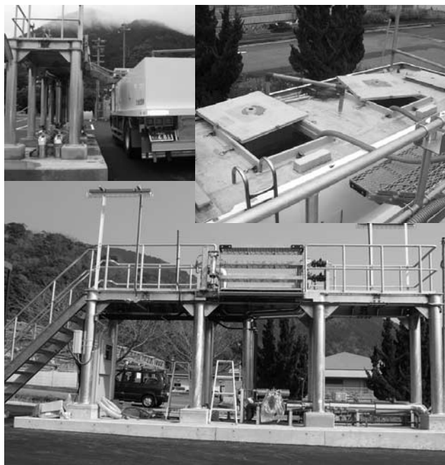
写真-3 大口分水施設及び給水状況
