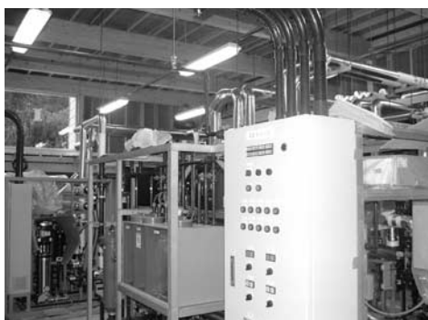
写真-2 脱塩施設内設備
