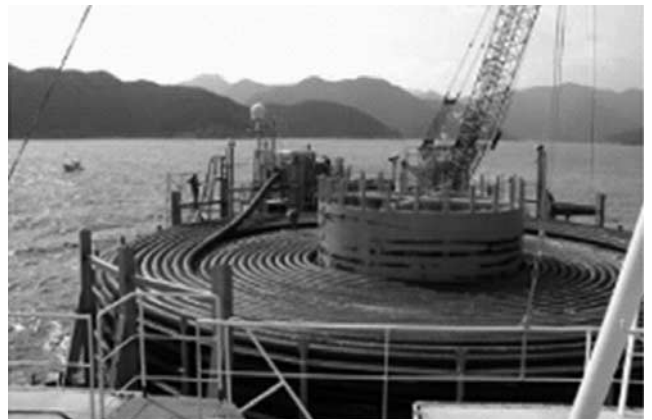
写真一七 ターンテーブルからの取水管送り出し
