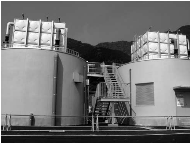
写真一六 取水ピット・機械棟・受水槽外観
