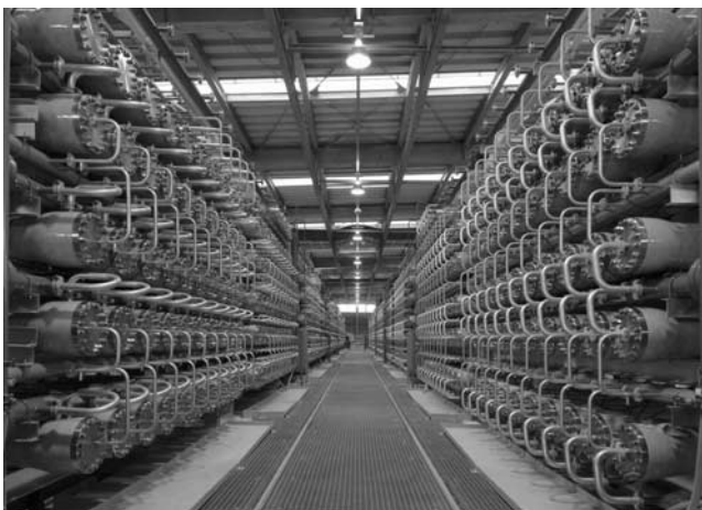
図-5 高圧RO膜のユニット
