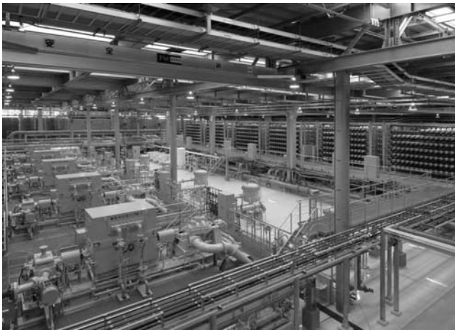
図-4 UF膜のユニット(奥)と高圧RO膜用ポンプ(手前)
