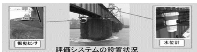
図-6 河川増水時の橋脚基礎安全性評価システム設置状況 6)
