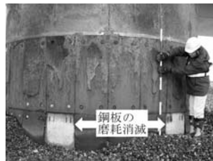
写真—4 鋼板の磨耗消失状況
