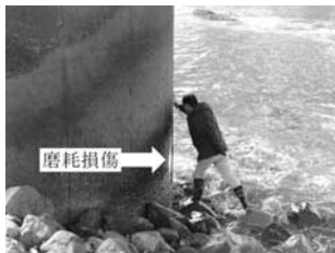
写真—3 橋脚磨耗状況
