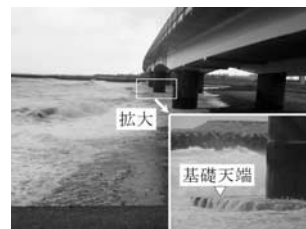
写真—2 基礎洗掘状況
