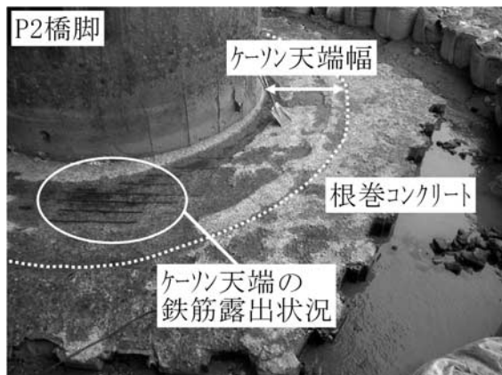
写真—5 基礎天端鉄筋露出
