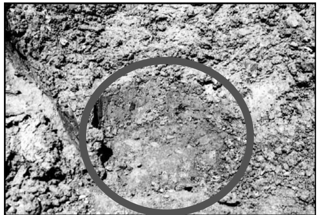
写真一七 基盤面への貼り付き状況
