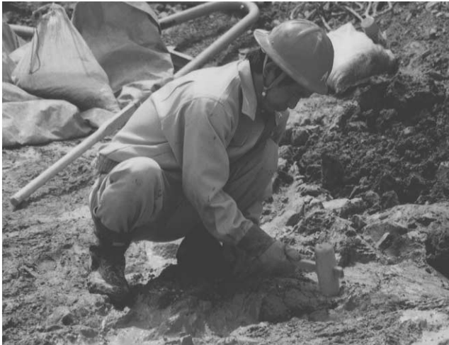
写真一五 在来工法（木槌を用いたコンタクトクレイ材の貼り付け）
