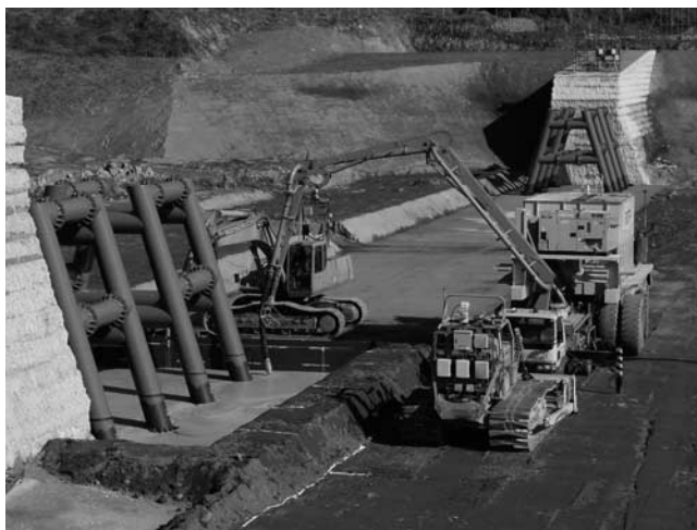
写真—6 アジテーター機能を具備した無人コンクリート運搬車と無人ポンプ車による高流動コンクリート打設
