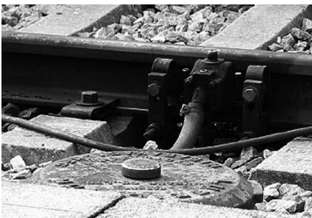
写真—3 レール塗油器(手前の蓋は油タンク)
