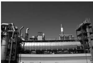
写真—2 熱分解ガス化炉
